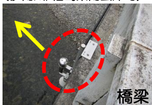
浜野雨量水位観測局 超音波式水位計 (伊南川/福島県南会津町)
