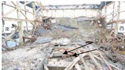
<オペフロの様子（崩落屋根等）>
