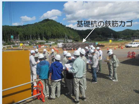
工事内容の説明後、写真背後の現場を確認！ 鉄筋カゴを間近で見る・触る体験をしました！
