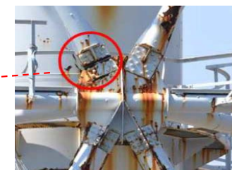
△ 破断箇所の様子▽
