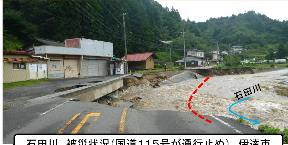
石田川 被災状況(国道115号が通行止め) 伊達市
