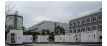
⑥ 水素製造システム (東北電力研究開発センター)
