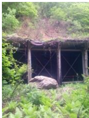
写真1：R400 玉梨 スノーシェッド落石状況
