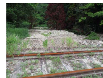
土砂堆積、土砂流入 (深沢橋りょう)
