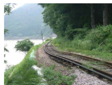
盛土地滑りによる線路沈下
