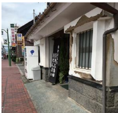
外壁漆喰破損箇所／窓まわり
