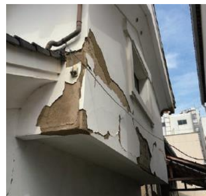
外壁漆喰破損箇所／建物側面
