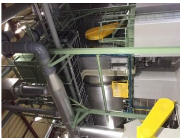
仮設乾燥施設(内部) < 県北浄化センター >
