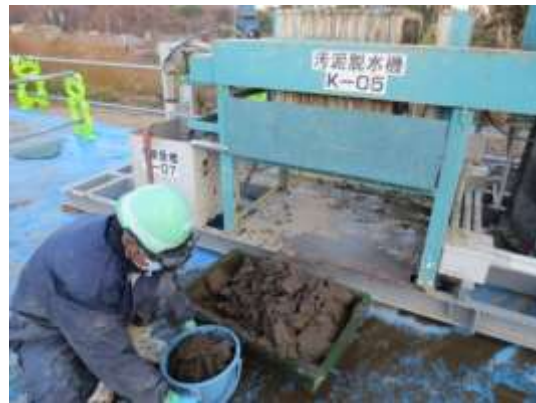
脱水装置と脱水汚泥
