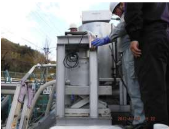
汚泥脱水機による脱水 (ジャッキアップして脱水)
