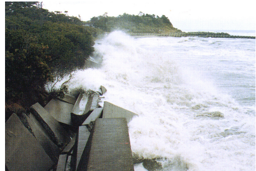
写真-9 堤防の決壊 (S62.9)
