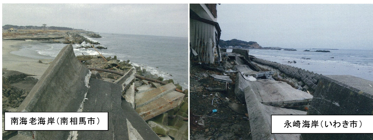
写真-8 東日本大震災による海岸保全施設の被害状況
