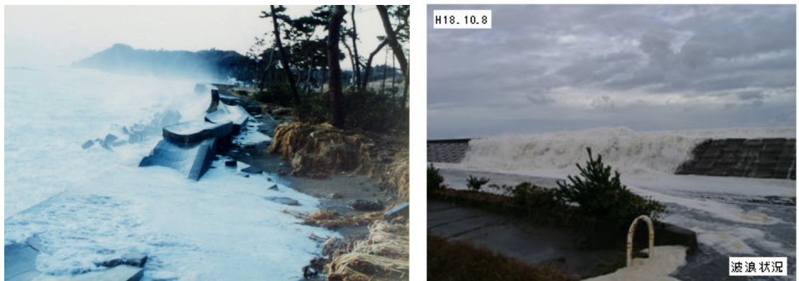
写真-6 高波による海岸保全施設の被災状況
