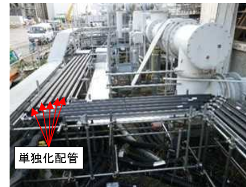
【中継タンクNo.4 北側】
