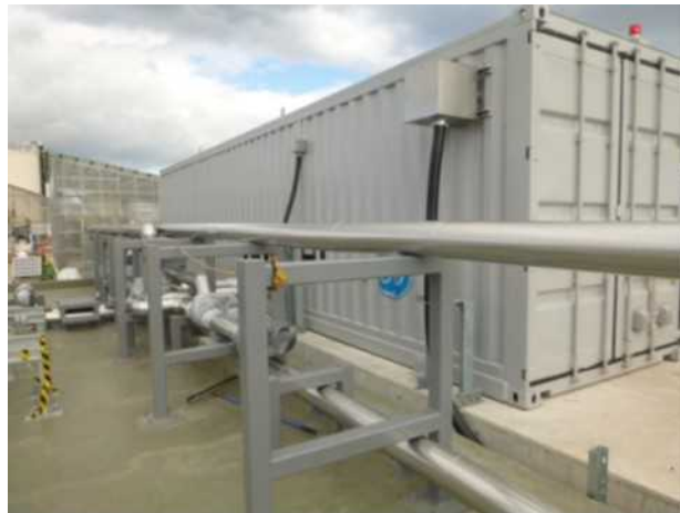
【地下水ドレン前処理装置の設置状況（4m盤）】
