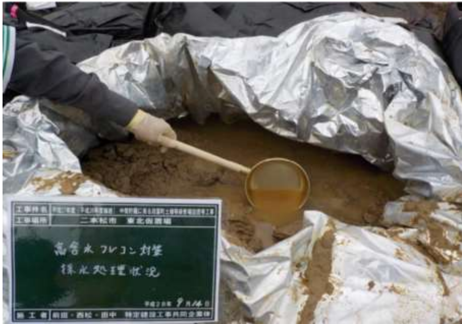
仮置場で内部に水が確認されたフレコンバッグ
