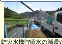
防火水槽貯留水の循環処理
