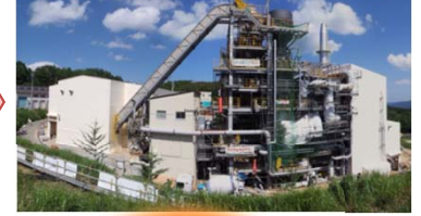
飯館村小宮仮設焼却炉
