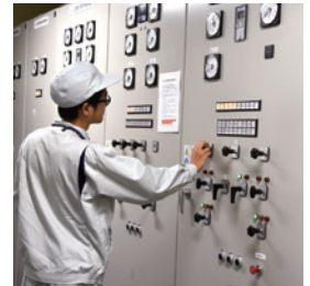
非常用発電設備
