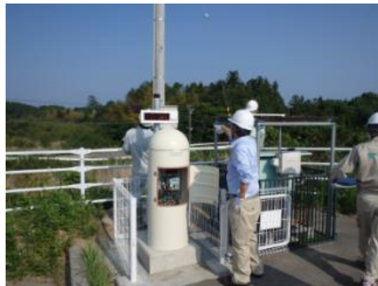
モニタリング設備の確認（双葉町）
