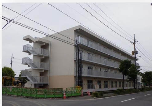
○復興公営住宅《北中央団地(福島市)》 1号棟24戸完成、2、3号棟40戸建設中
