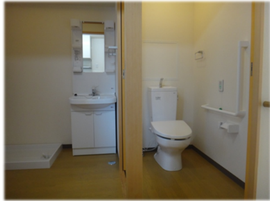
2 方向からの介助が可能なトイレ
