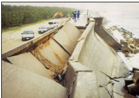
堤防の被災状況（山元町）
