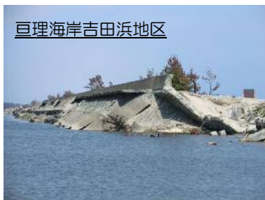
堤防の被災状況(亘理町)
