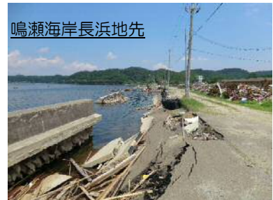
堤防の被災状況(東松島市)
