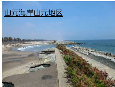
堤防の被災状況(山元町)
