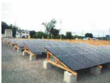
写真5-28 太陽光パネルを設置した木製架台
