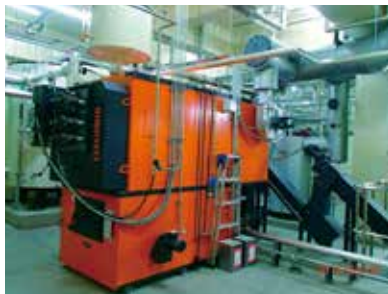
写真5-30 西会津町立西会津小学校に導入されたチップボイラー（校舎内暖房用）
