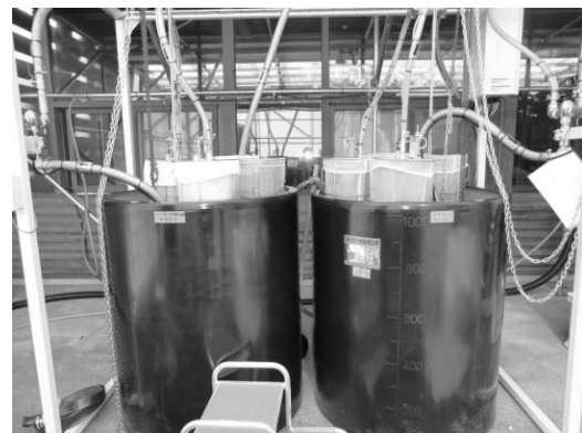
図-9 汚染水処理タンク
