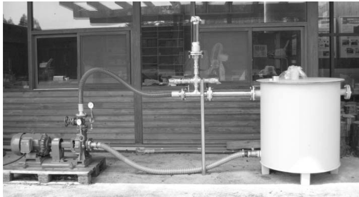
図-3 排煙処理装置の全体写真 右から水タンク、スクラバー、ポンプ
