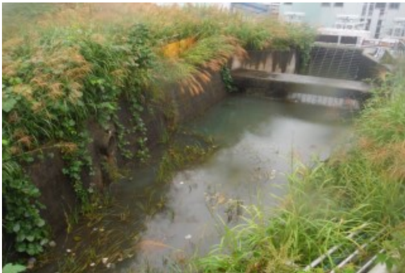
【写真①】大芋沢～K排水路暗渠接続部(清掃前)
