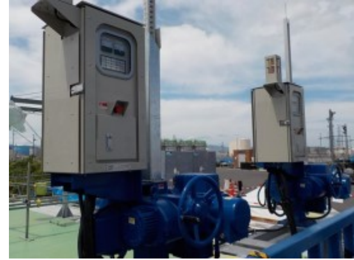
写真 自動・遠隔制御盤設置状況
