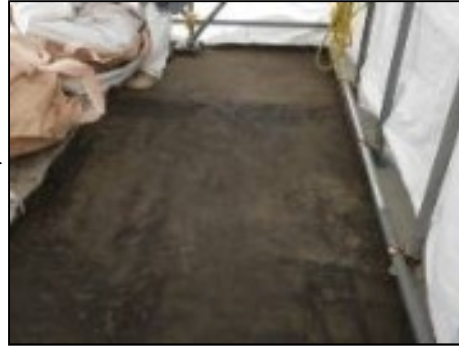
【写真⑥】仮設テント内ルーフブロック・敷砂撤去状況 (3月31日)
