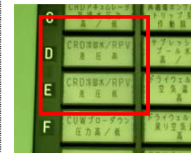
図14. 制御棒駆動機構冷却水差圧高/低警報分離状況
