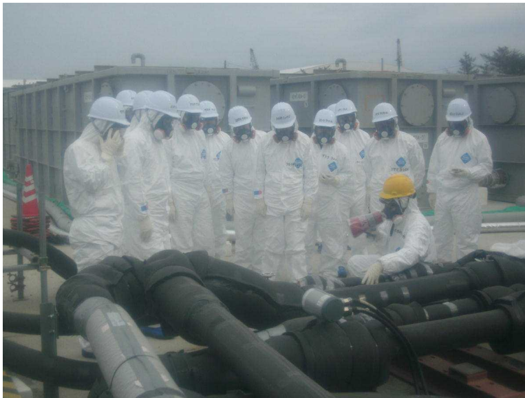
追加で取り付けた発泡ウレタン厚さ30mmの保温材 〔水処理設備の廃液供給ポンプ廻り〕
