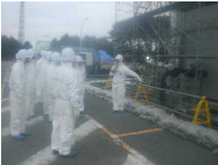
保温剤を取り付けした配管、土 のうによる流出防止の堰 〔原子炉注水系の高台炉注水タ ンク〕
