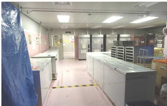
保冷剤冷凍庫の配備
