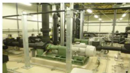
②浄化水移送ポンプ・攪拌ポンプ (各2台)
