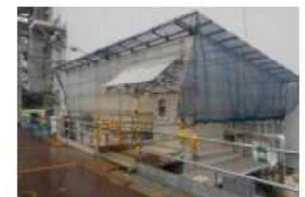
②サブドレン中継タンク (5基)
