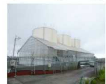
③集水タンク (3基)
