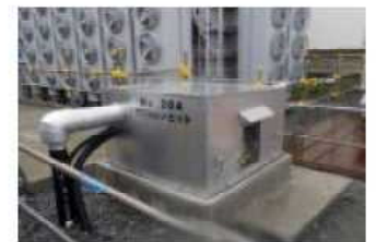
①サブドレンピット (41カ所)
