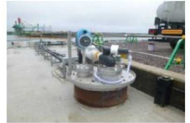
①地下水ドレンポンド（5カ所）
