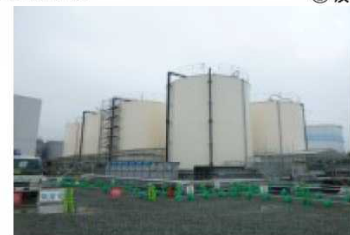
⑥一時貯水タンク（7基）
