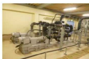
②移送ポンプ
