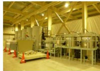
④サブドレン他浄化設備
