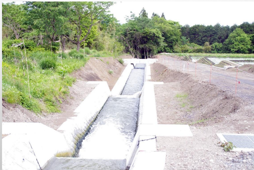
写真：落差工が整備された農業用水（静岡県富士宮市）
