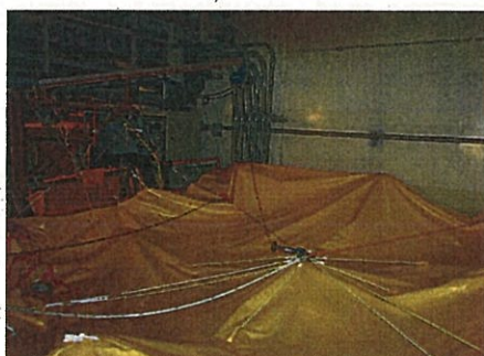
2014年6月の設置状況
