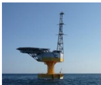
洋上変電所 「ふくしま絆」
