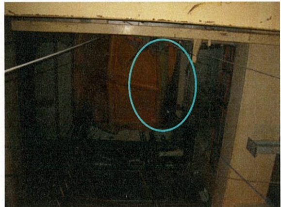
現在のずれている状況 (2015年5月21日撮影)
