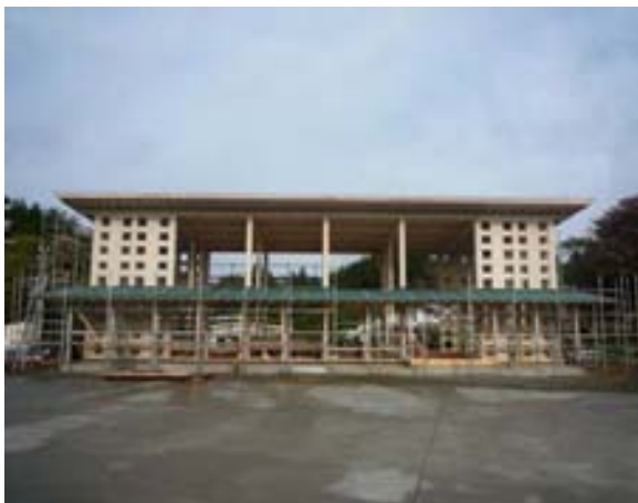
写真3 高倍率耐力壁と重ね梁を組み合わせる施工した事務所
