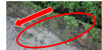
電線が水路に近かったため、侵入を許してしまった
