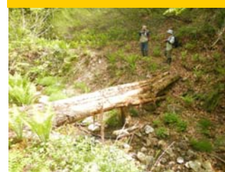
吉尾峠の丸木橋損傷箇所
