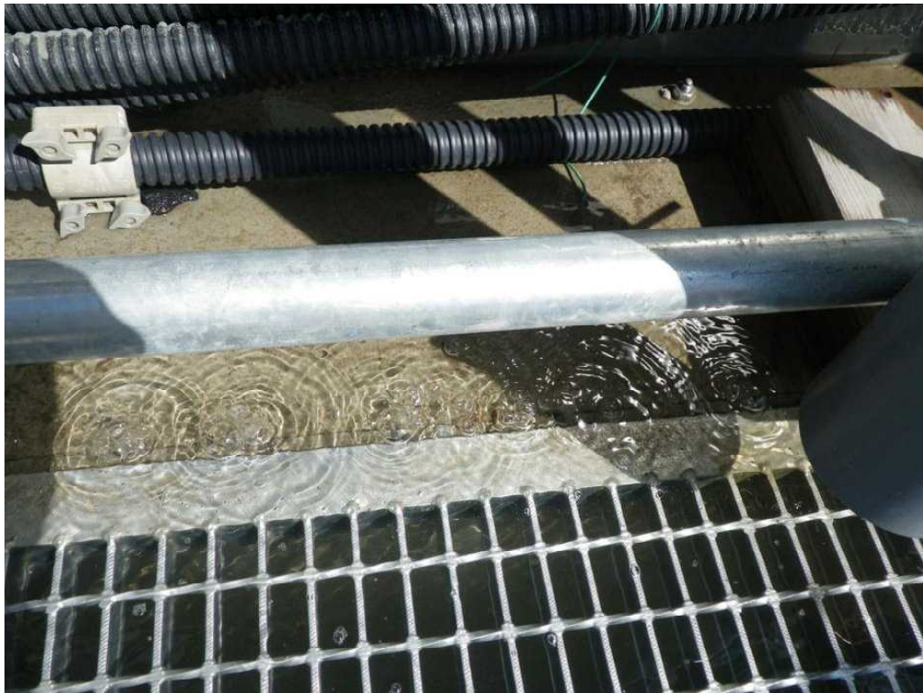
3 外周堰内側溝からの気泡発生状況
