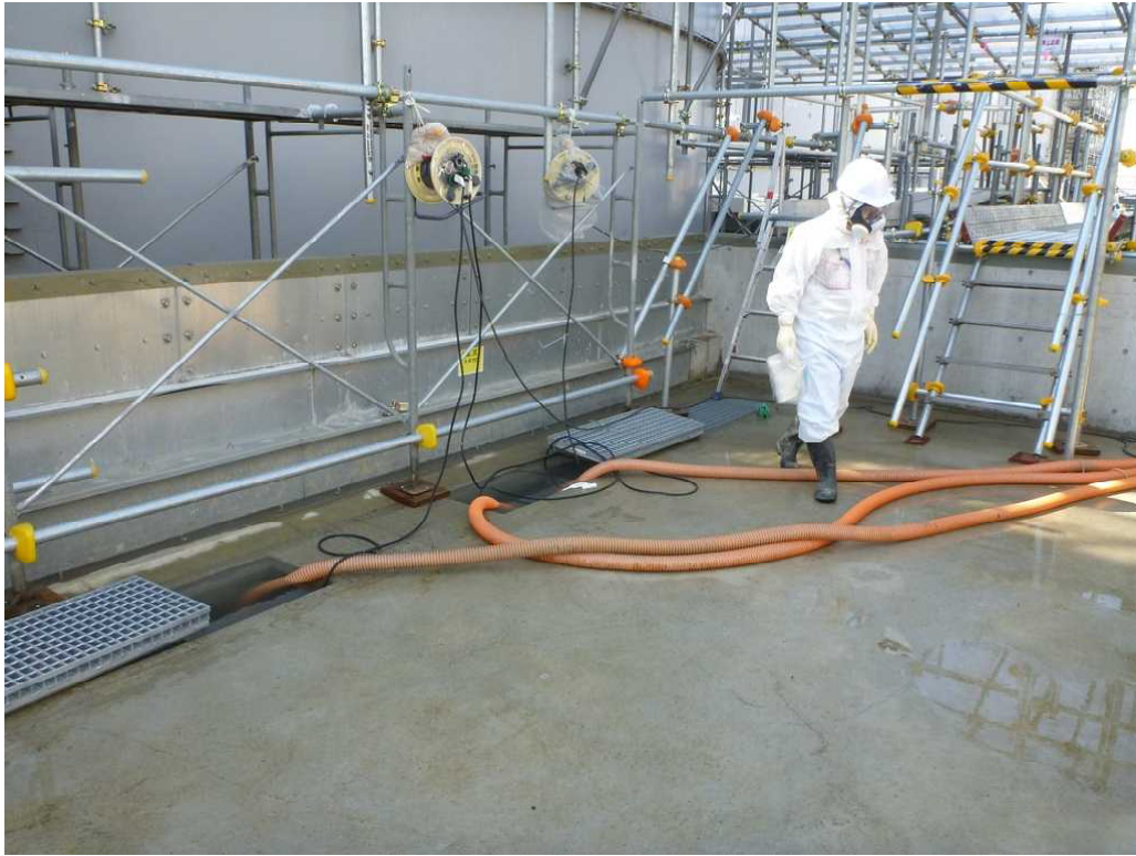
4 外周堰内側溝からの雨水回収状況
