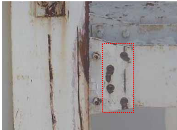
⑤ 9a通り柱梁接合部ボルト欠落
