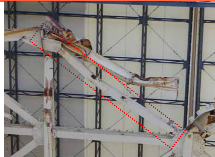
④ 9a-8a通り間上部鉄骨損傷
