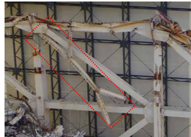
⑥ 西面10a通り付近上部鉄骨損傷
