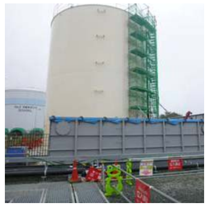
一時貯水タンク
