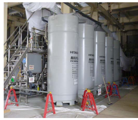
浄化設備（吸着塔）
