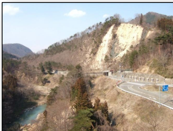
東北地方太平洋沖地震による地すべり状況 ・国道399号(福島市)
