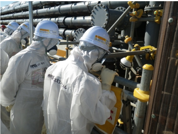
K排水路仮設ポンプ（K排水路→C排水路）設置現場
