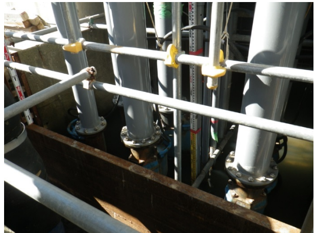
仮設ポンプ（8台）と仮堰の状況（水は越流していない）
