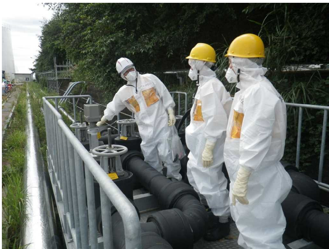
③ 排水ライン流量調整弁の状況を確認した。(午前9時46分)
