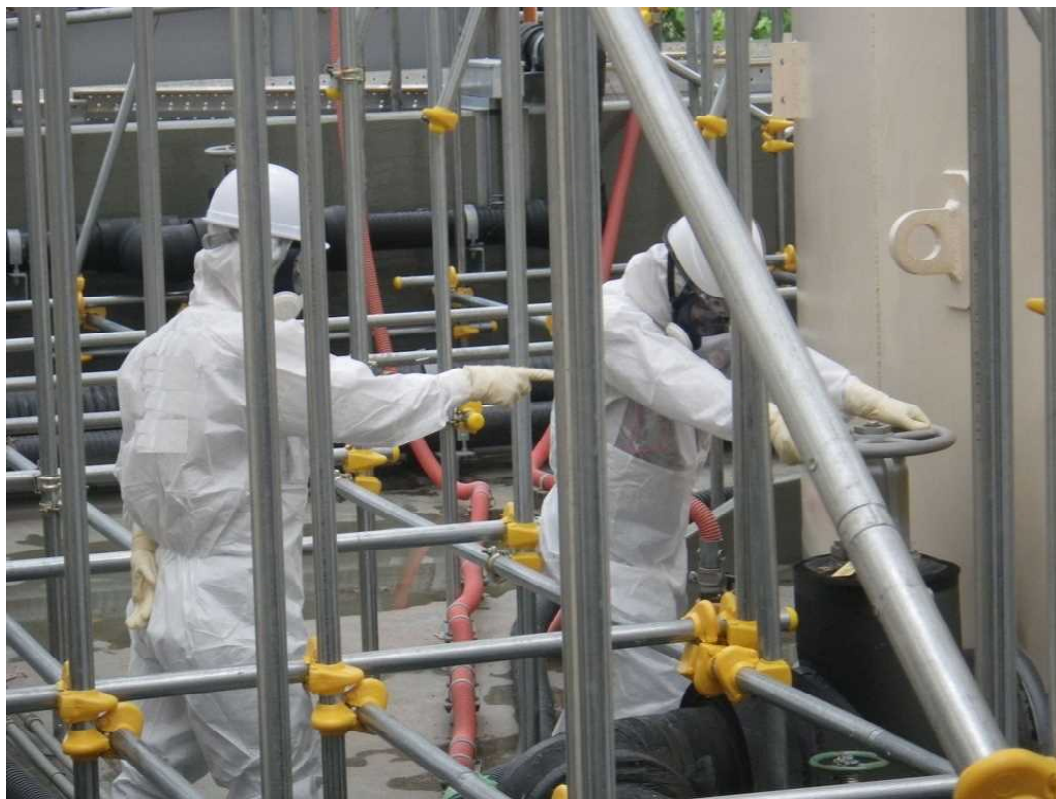
② 一時貯水タンクの出口弁を開操作している状況を確認した。(午前9時32分)
