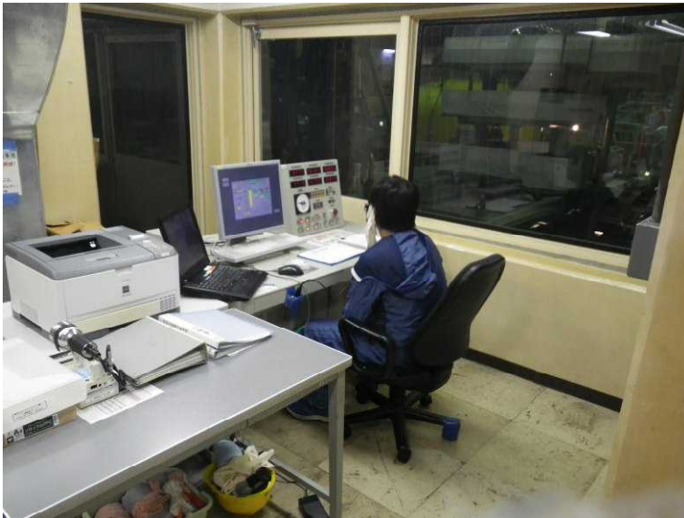
・燃料取替機操作室。オペレータは取替機上の作業員と連絡を取り合い、作業を進めている。
