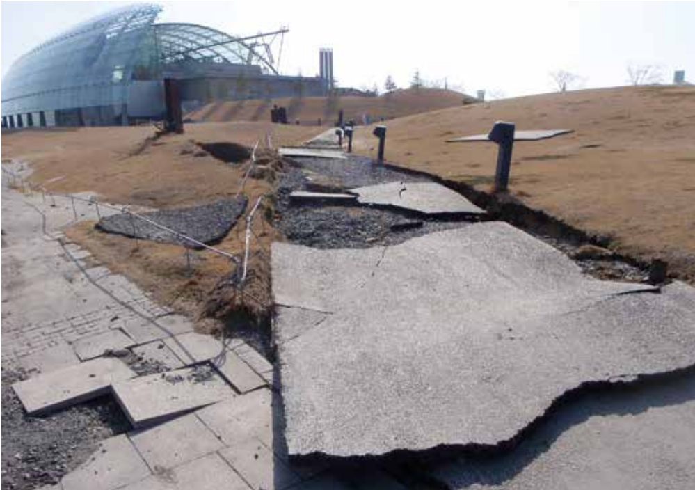
いわき市アクアマリン地割れ 平成 23 年 3 月 13 日撮影
