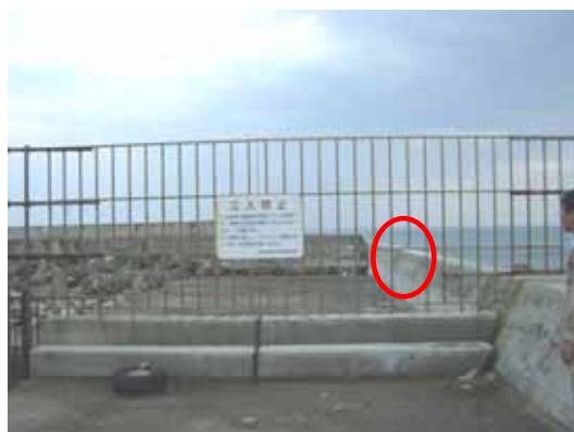
進入防止柵の破損
