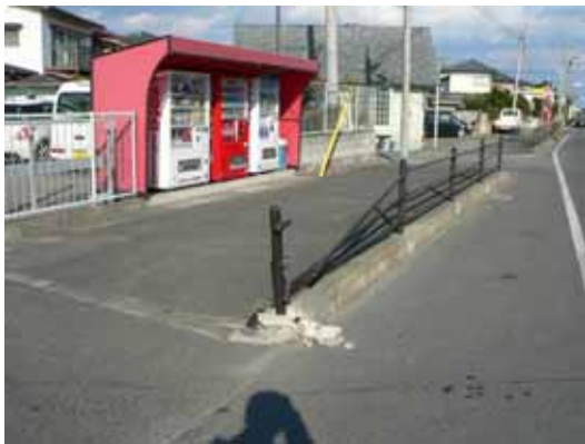
交通安全施設の破損
