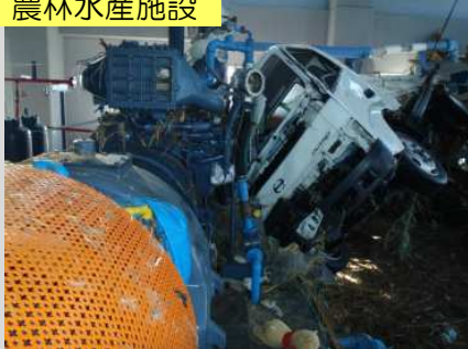
八沢排水機場の被害状況(3/29)
