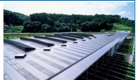
太陽光発電導入事例 (郡山市・福島県農業総合センター)
