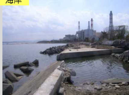
岩間・佐糠地区海岸の被害状況(5/26)
