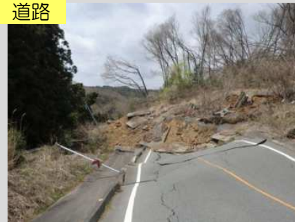
いわき石川線の被害状況(4/12)
