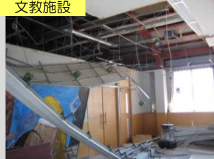
岩瀬農業高校の被害状況(3/15)
