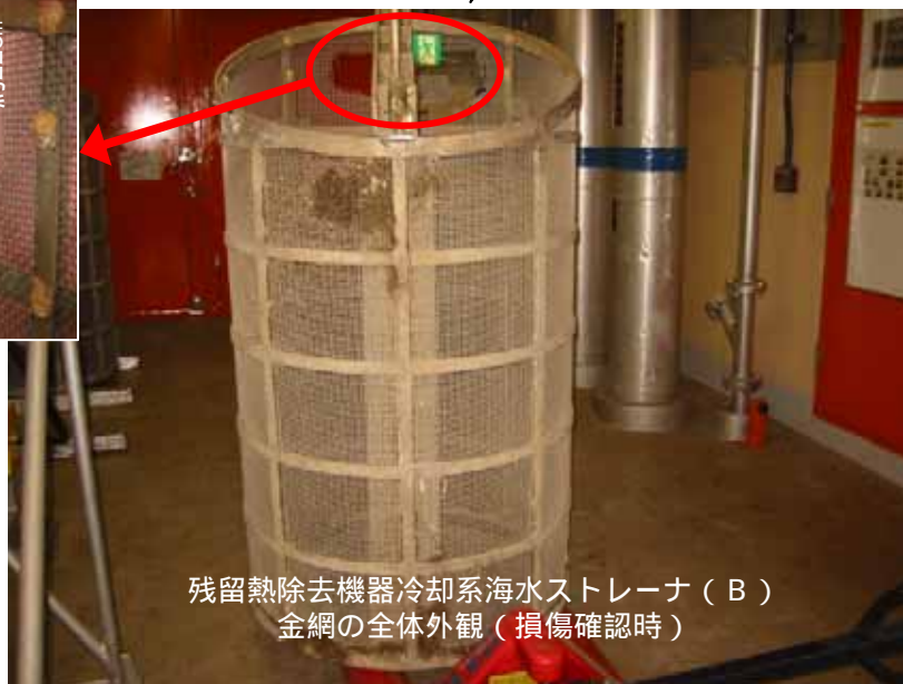
残留熱除去機器冷却系 (B系) 概略図および金網の損傷状況写真
