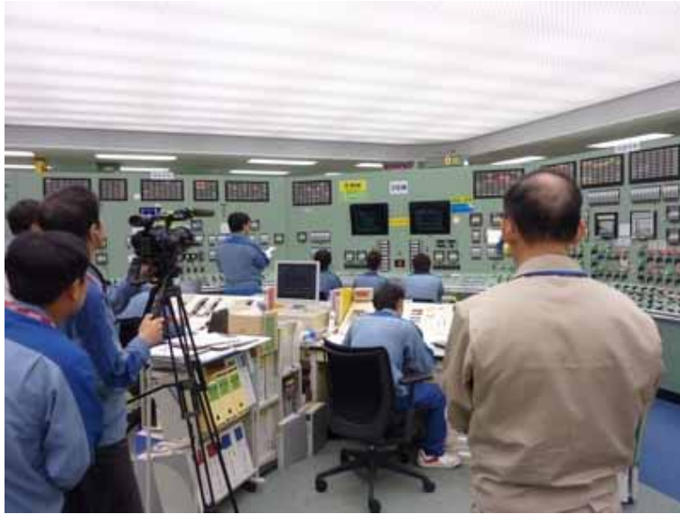
9月18日(土) 原子炉起動操作状況の確認(中央制御室)
