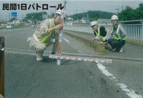
路面の段差確認
