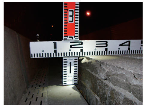
路面隆起状況
