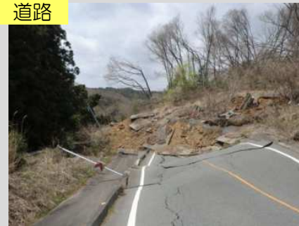
いわき石川線の被害状況(4/12)
