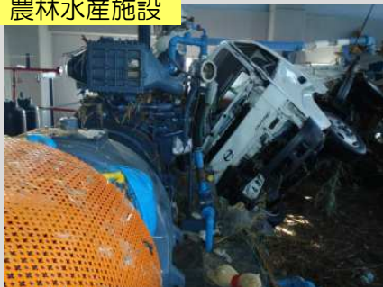
八沢排水機場の被害状況(3/29)
