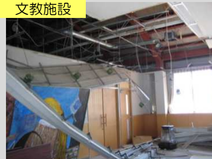
岩瀬農業高校の被害状況(3/15)
