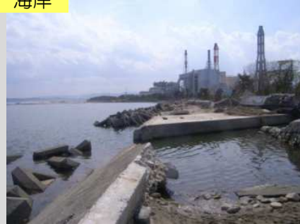
岩間・佐糠地区海岸の被害状況(5/26)
