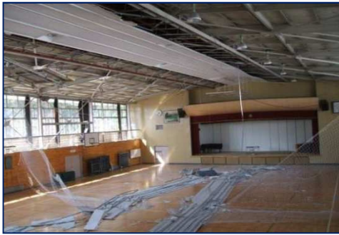
小野高校体育館の被害状況（4/15）
